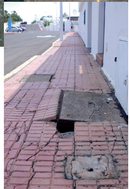
El deterioro de vías y aceras es más que evidente
